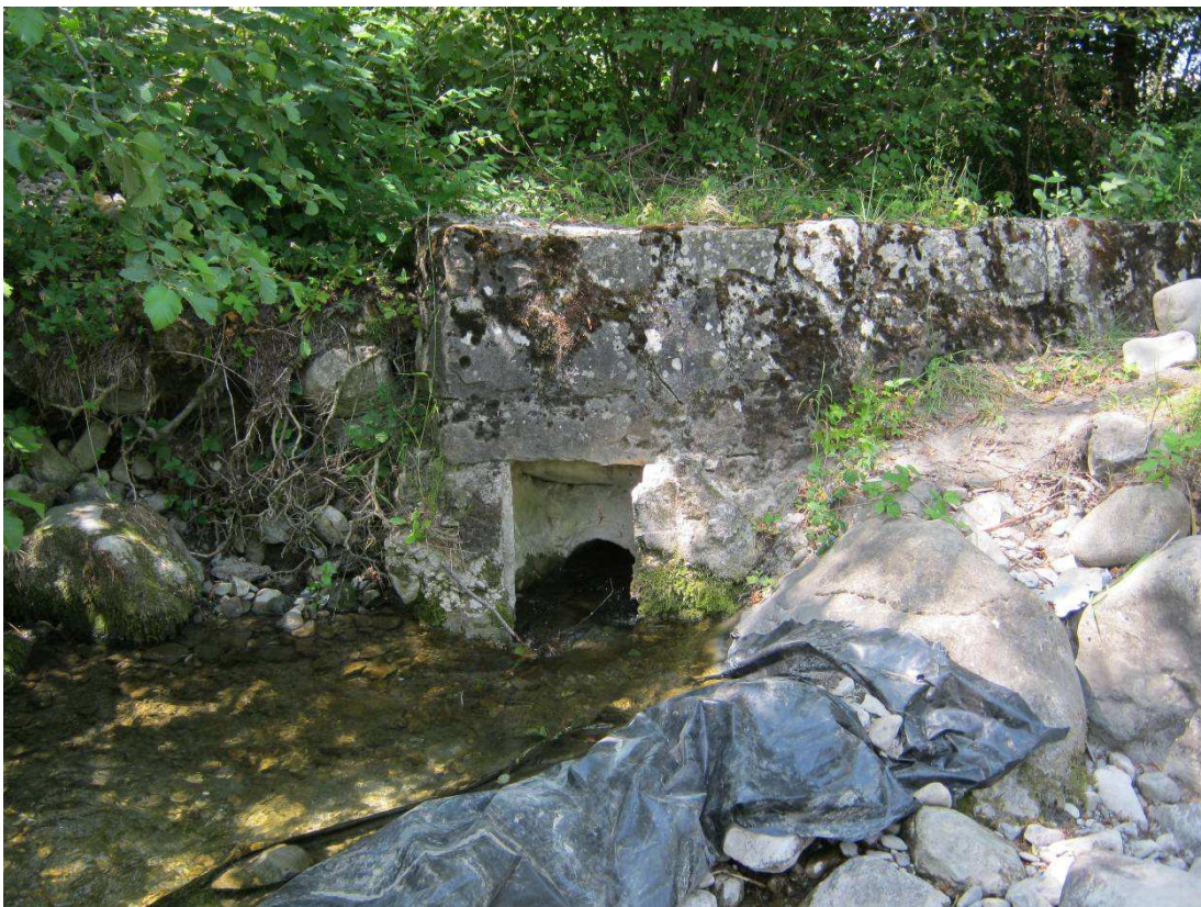
Figure 19 : Prise d'eau d'un canal d'irrigation dans le torrent d'Ancele. La conception de la prise ne permet pas de réguler le débit entrant
